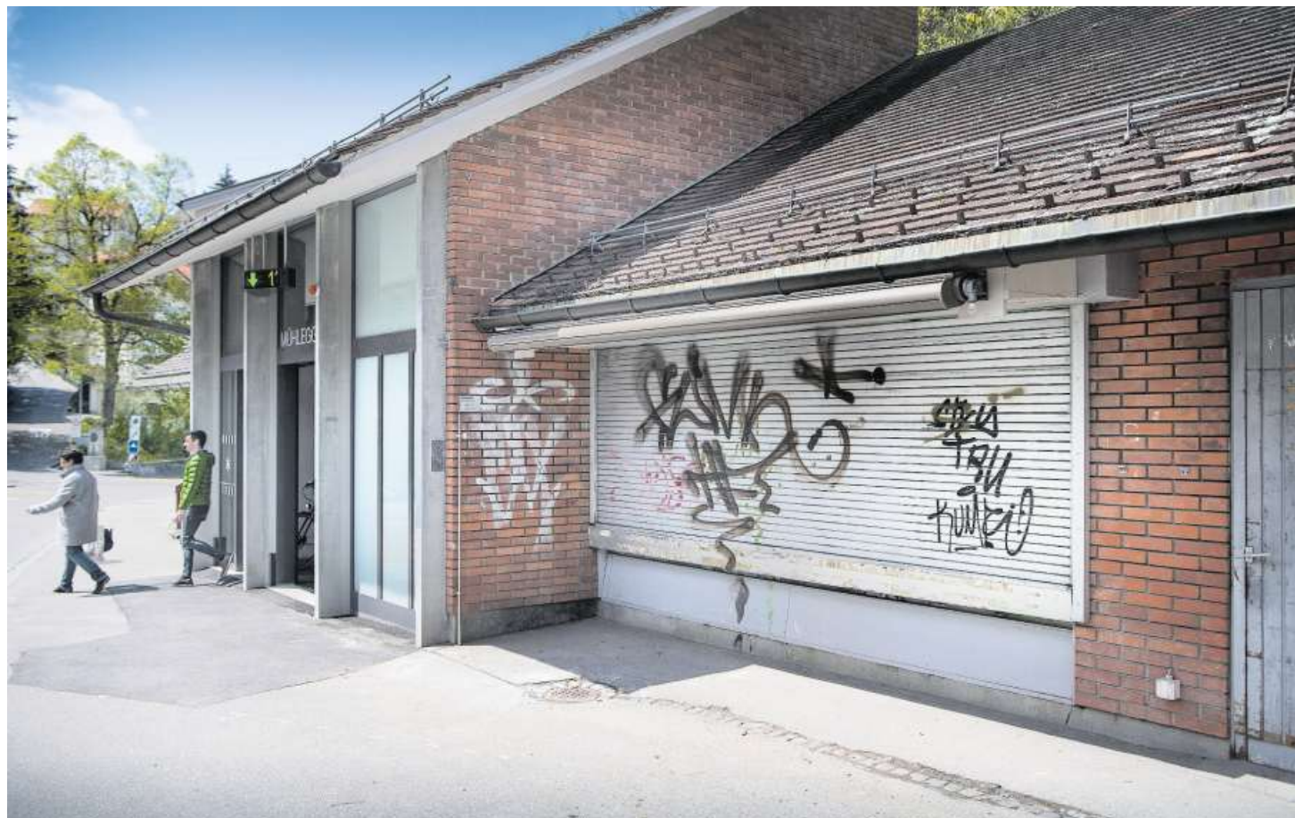
Heruntergekommen und mit Sprayereien übersät: Der ehemalige Kiosk an der Bergstation der Mühleggbahn in St. Georgen.
